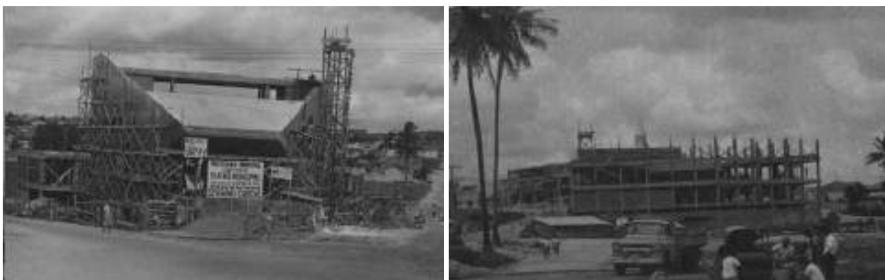
Figura 12: Imagens da construção do TMSC, possibilitando a visualização da estrutura de suporte
