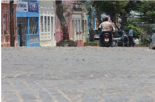
Figura17: Ponto 10 – Rua desnivelada
