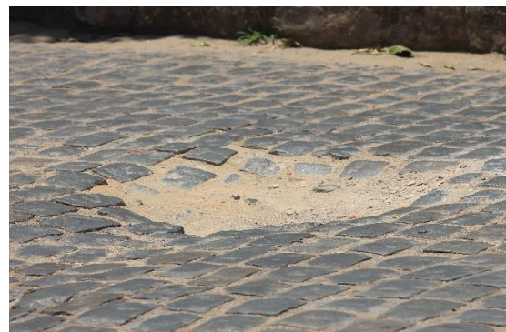
Figura16: Ponto 09 – buracos no calcamento
