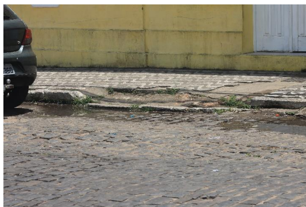
Figura 19: Ponto 11 – acúmulo de água
