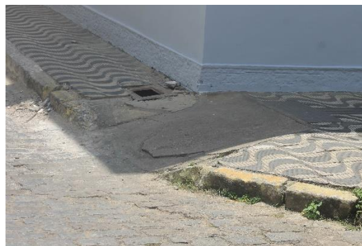
Figura 27: Ponto 26 – guia rebaixada
