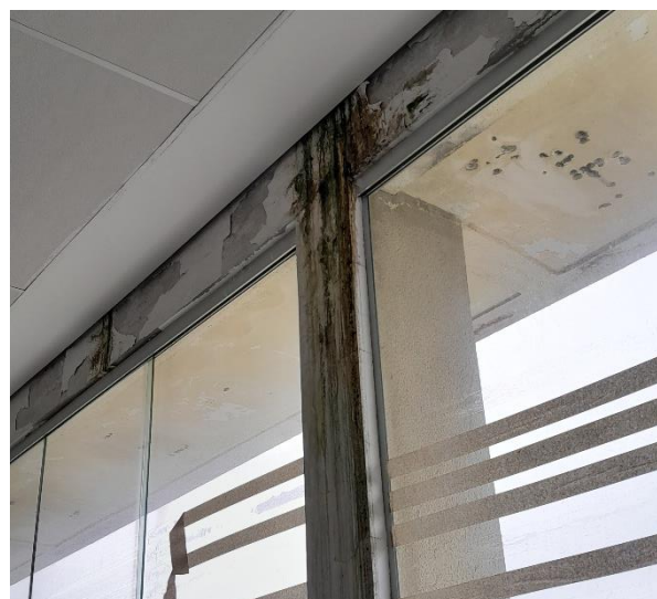
Figura 7 – Infiltração no Ateliê do pavimento 3.
