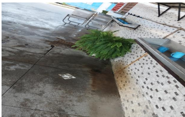
Figura 3 – Corrosão e vazamento no bebedouro
