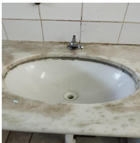
Figura 2 – Pia do banheiro feminino com vazamento
