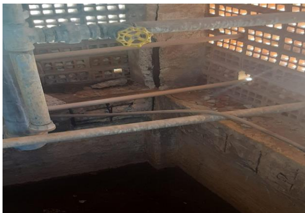
Figura 4 – Patologias no reservatório de água
