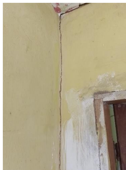
Figura 2 – Rachadura causada pela vibração do solo
