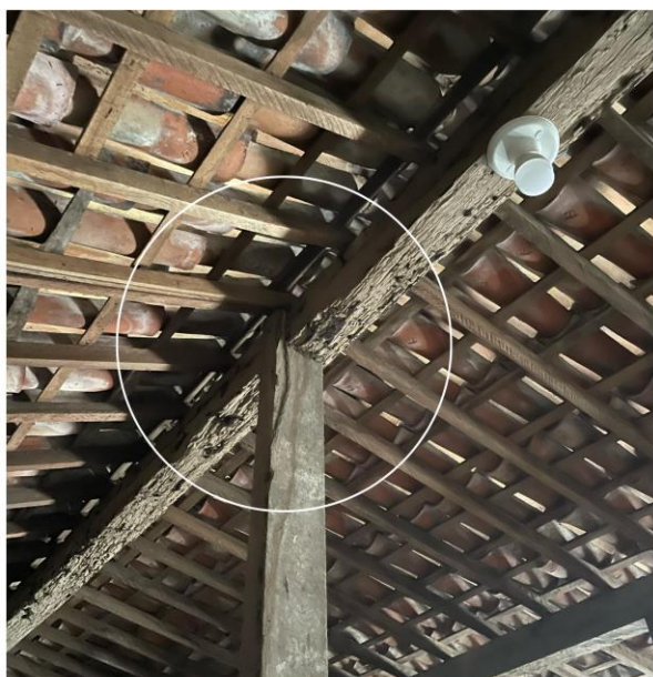
ESTRUTURA EM MADEIRA SOB AÇÃO DE CUPINS. FONTE: ANTÔNIO PIRES, 2025
