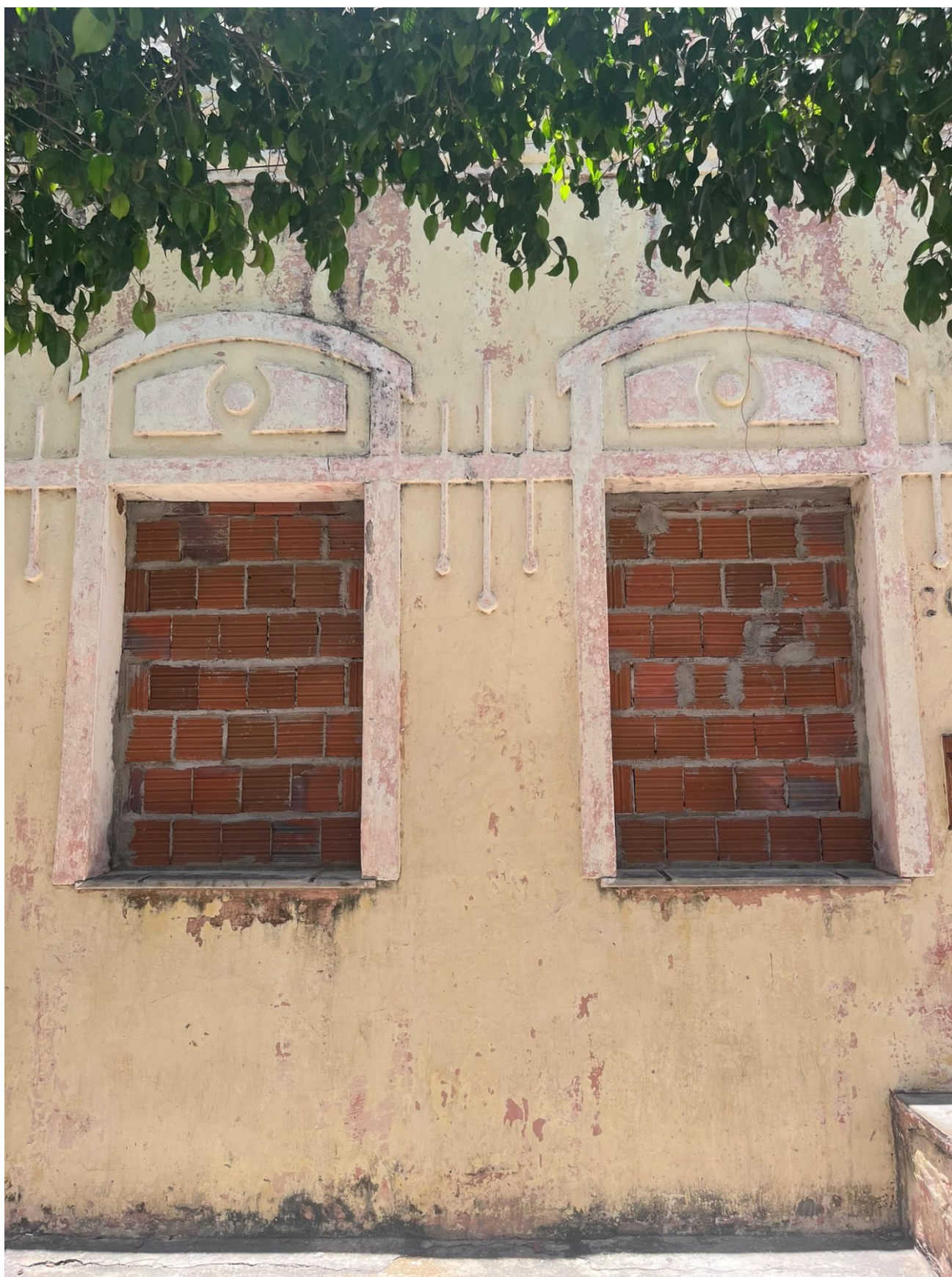
Edificação sem uso e em estado de degradação.
