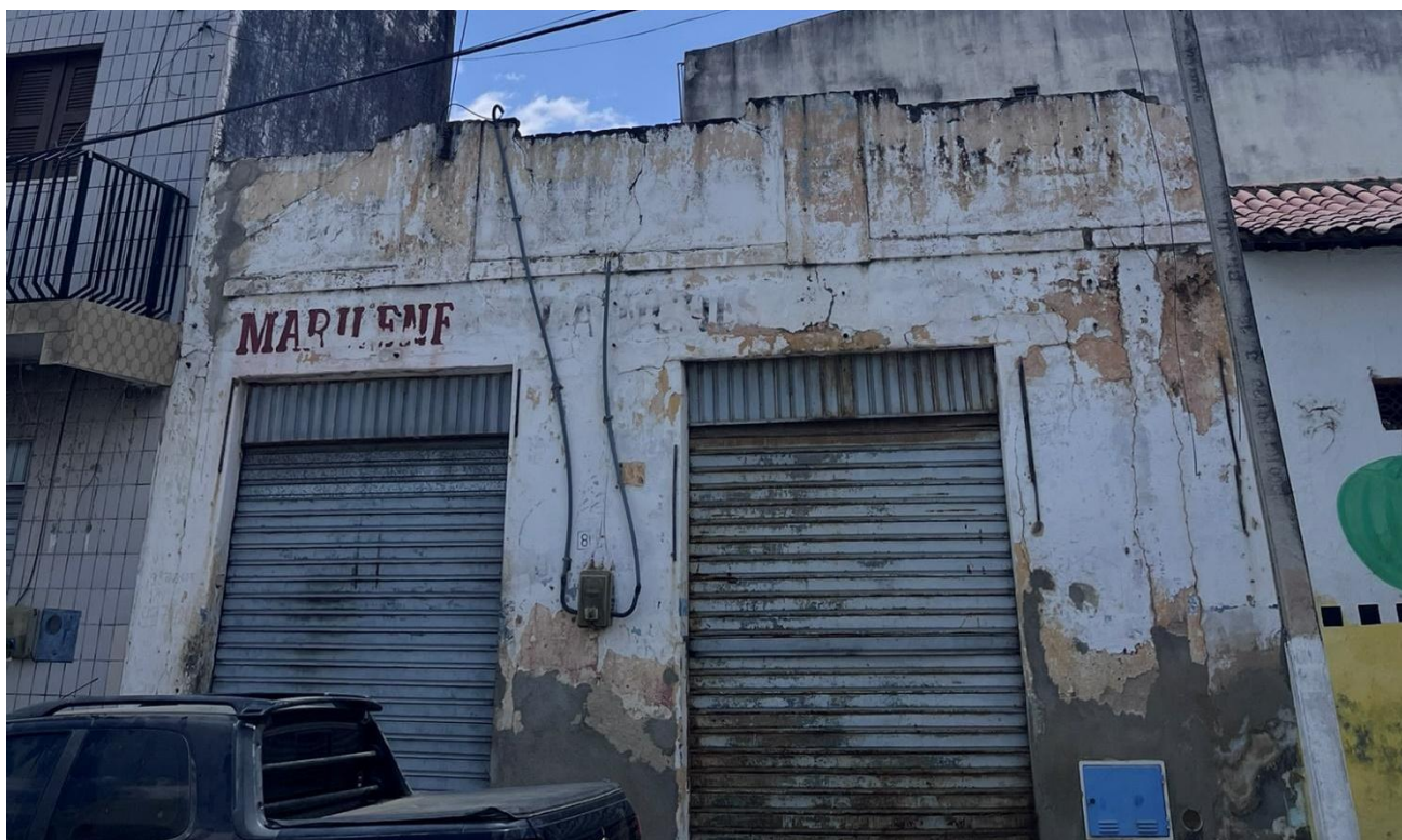
Platibanda de edificação antiga, local atualmente fechado e em degradação.
