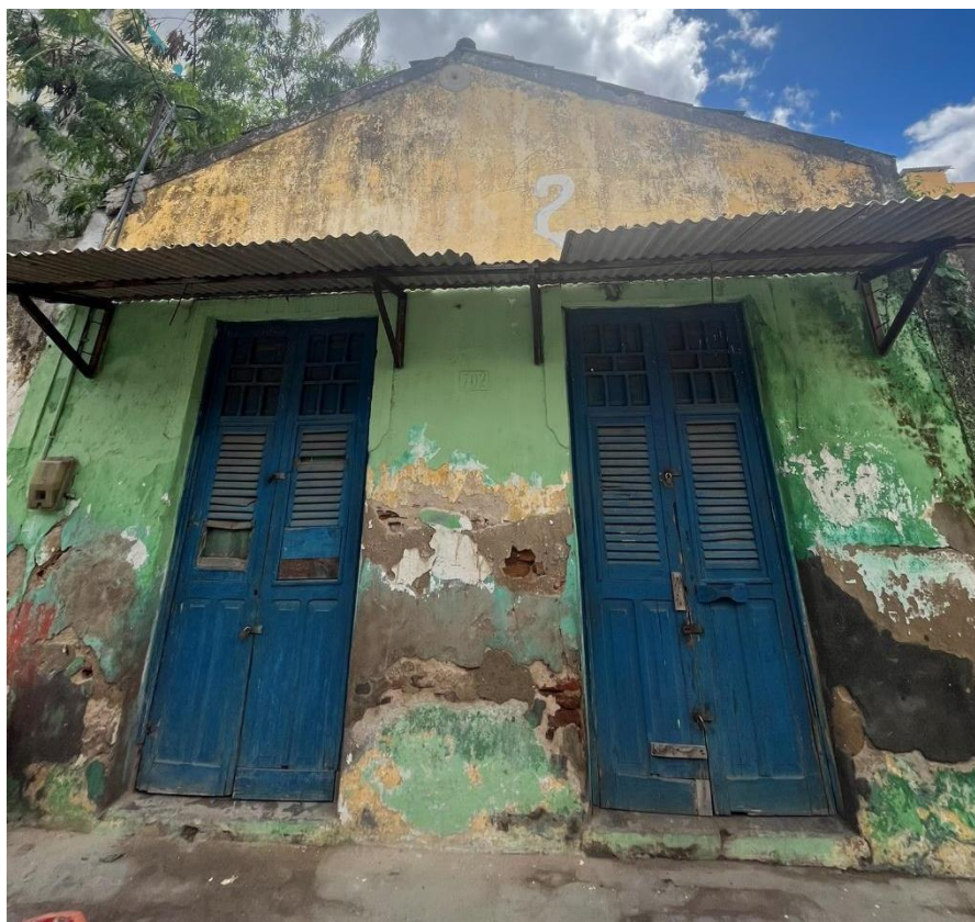
Edificação antiga e em estado de degradação.
