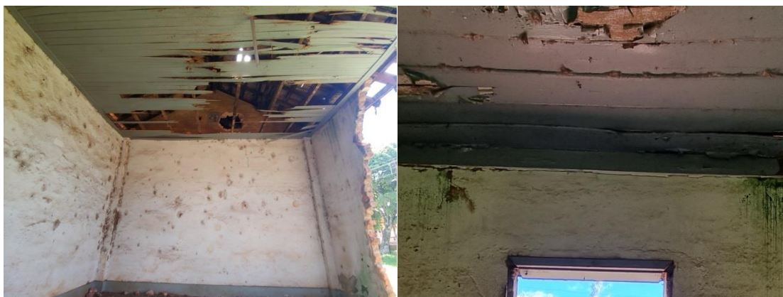
Figura 11: Patologias dos forros da edificação.
