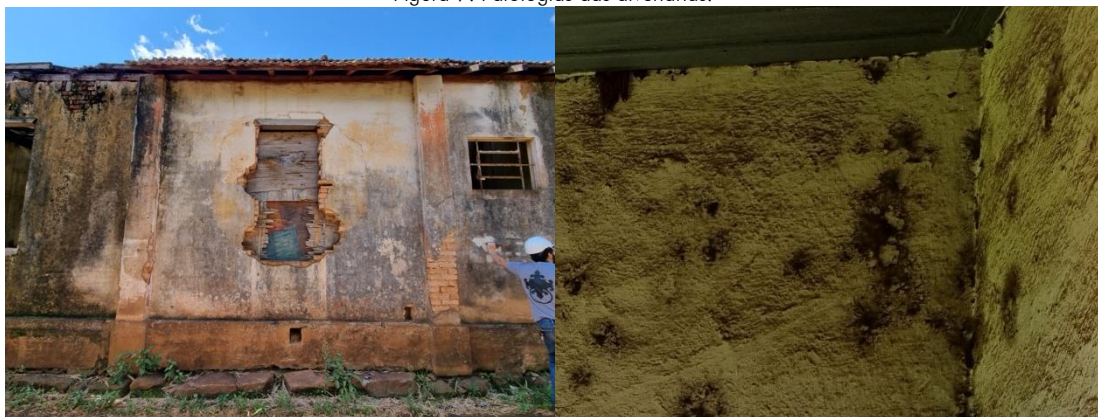
Figura 9: Patologias das alvenarias.
