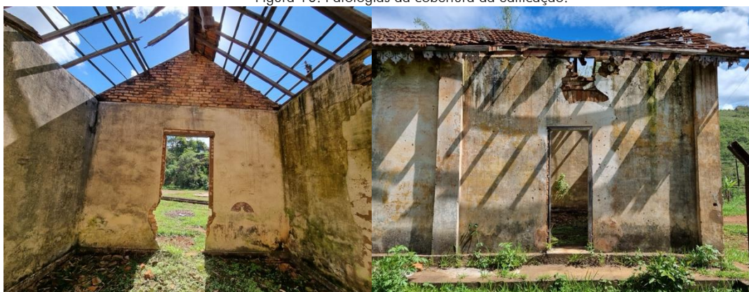
Figura 10: Patologias da cobertura da edificação.
