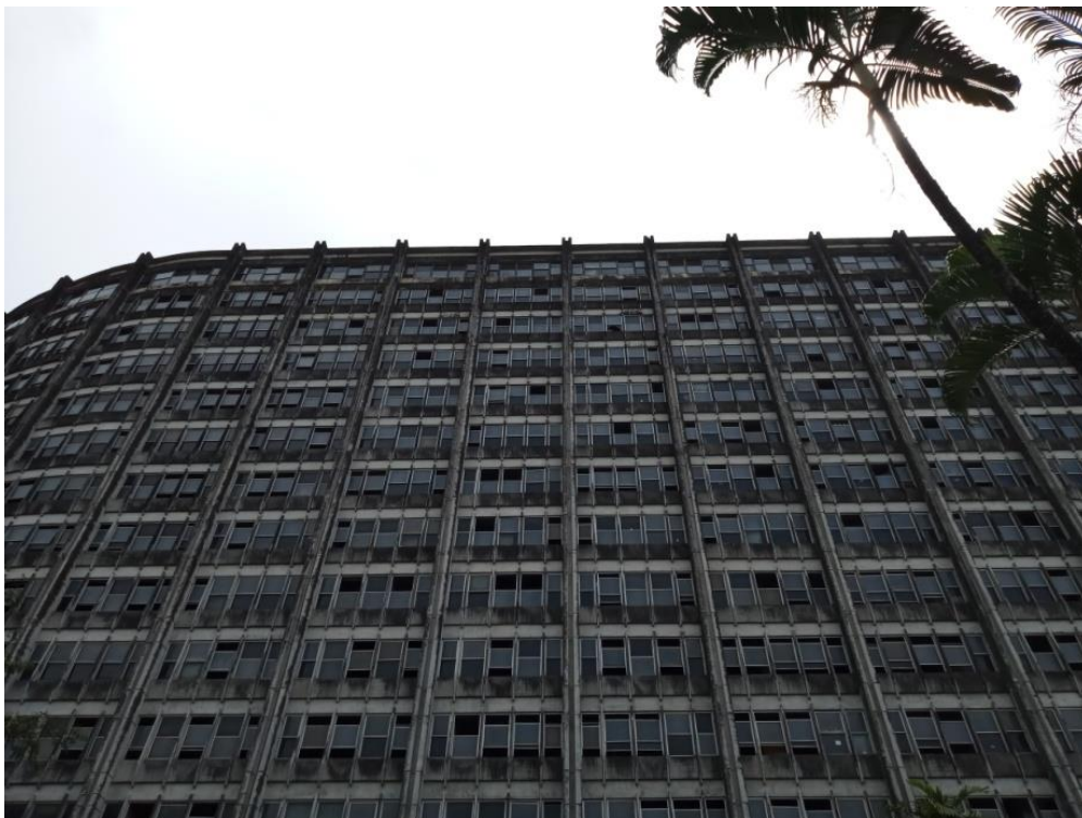
Figura 22: Fachada leste da Sede com maior quantidade de sujeidade e danos em decorrência das chuvas de vento vindas do sudeste.
