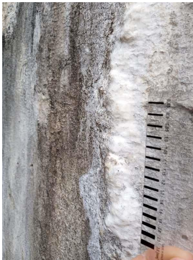
Figura 26: Efflorescências no embasamento da fachada oeste próximo a passarela de acesso ao IFPE.
