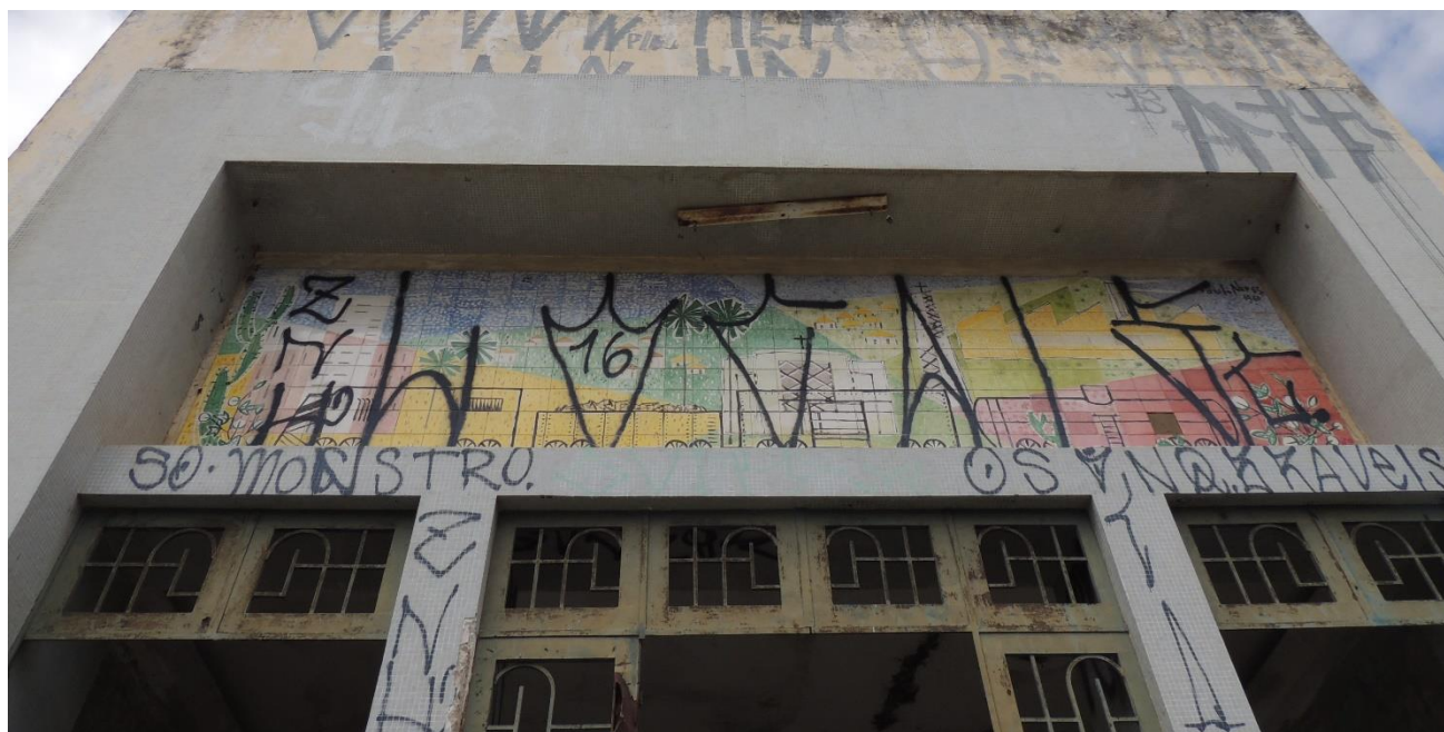
Figura 4: Vandalismo realizado por pichadores no painel do prédio da Estação Nova de Campina Grande.
