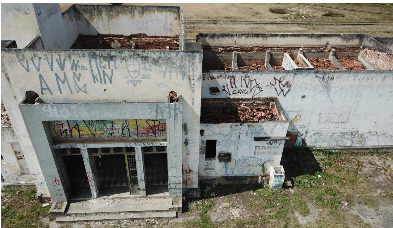
Figura 3: Depredação e abandono do edifício que abrigava a Estação Ferroviária de Campina Grande.
